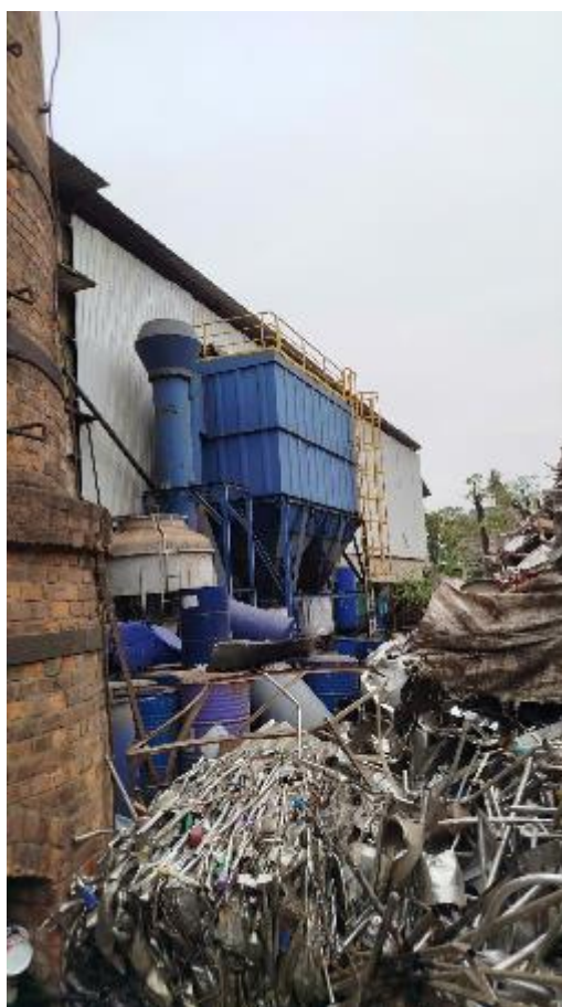
Hệ thống xử lý bụi máy làm khuôn furan
