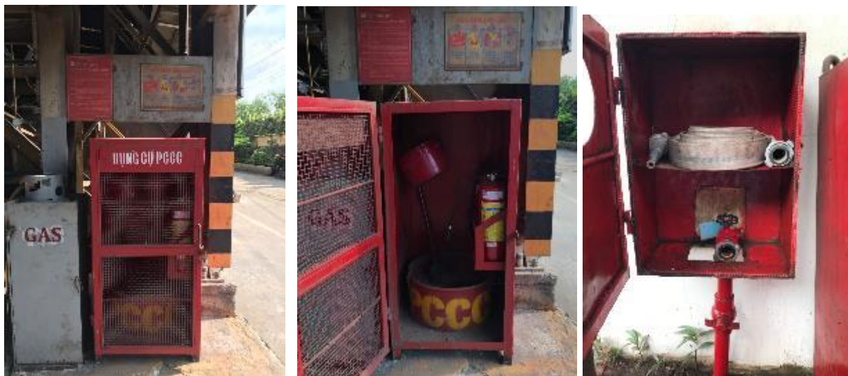
Hình 3.21: Một số hình ảnh các thiết bị PCCC của nhà máy
