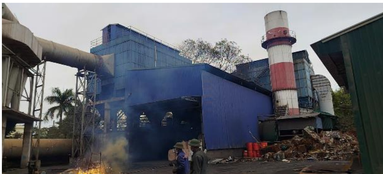
Hình 3.9: Hình ảnh hệ thống xử lý khí thải lò trung tần
