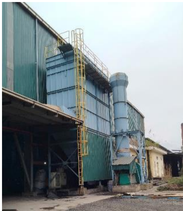
Hệ thống xử lý bụi máy làm khuôn cát tươi
